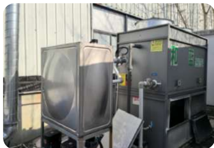
冷却循环水塔
