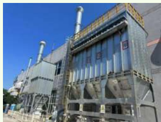
脉冲除尘设备
