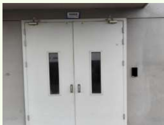
空压机设备单独设置机房隔绝噪声
