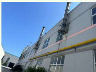
燃烧废气净化设备
